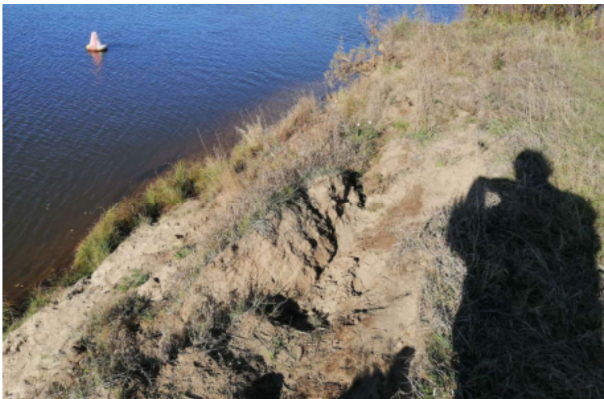
Рисунок 8.6 Внешние проявления оползневых процессов (плоскость срыва блока песчаного грунта)
