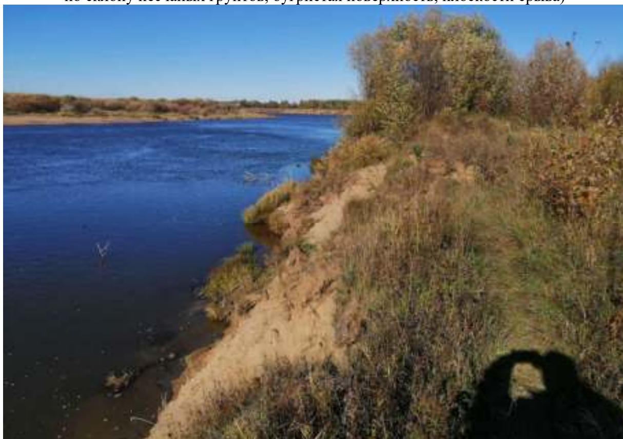
Рисунок 8.5 Внешние проявления обвально-оползневых процессов (блоки перемещенных по склону песчаных грунтов, бугристая поверхность, плоскости срыва)
