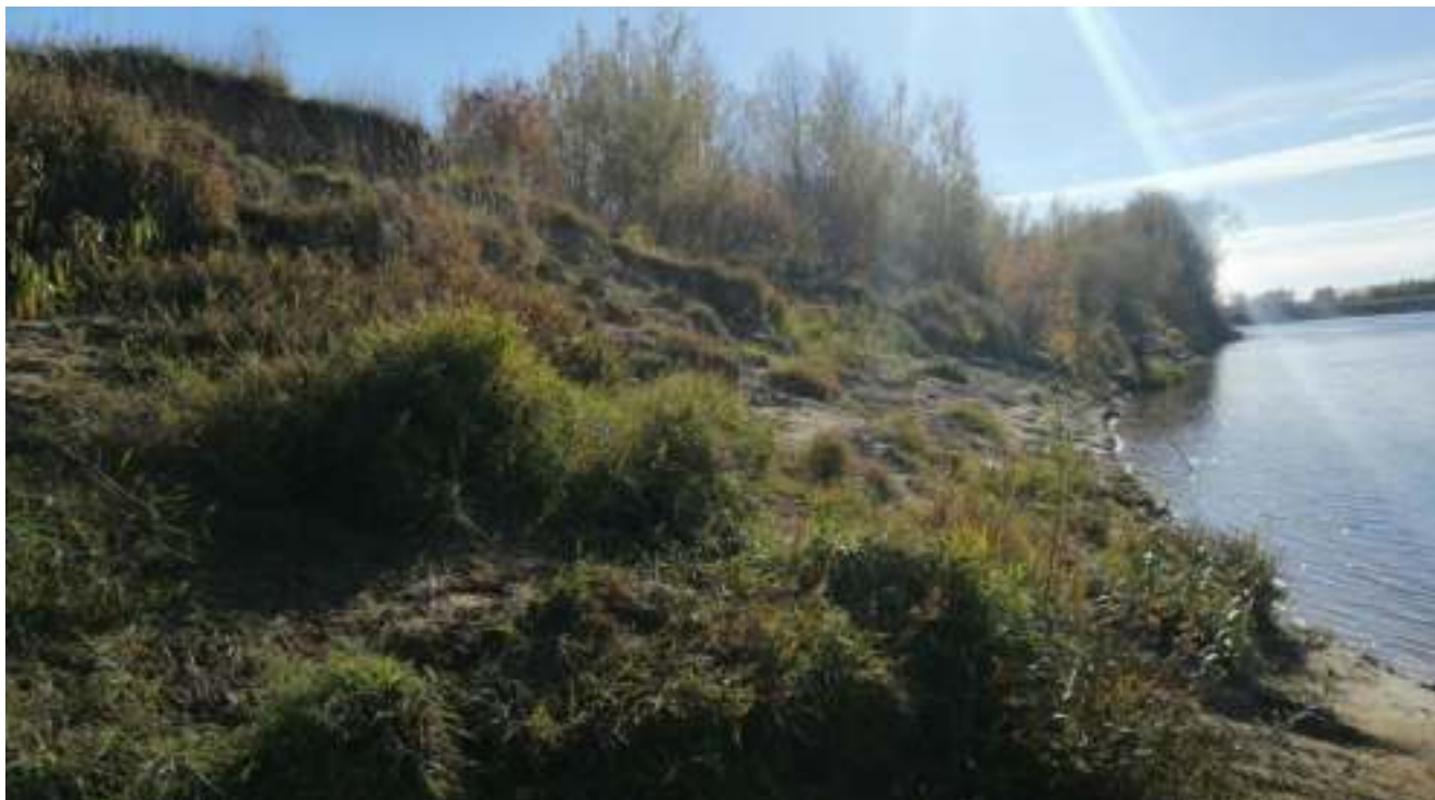
Рисунок 4.2 – Деформируемый береговой откос р. Сысолы в центральной части западной окраины участка изысканий
