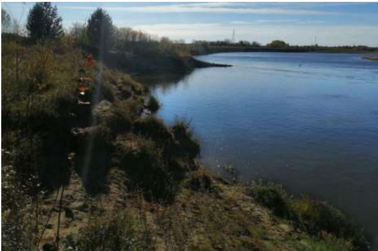
Рисунок 8.4 Внешние проявления обвально-оползневых процессов (блоки перемещенных по склону песчаных грунтов, бугристая поверхность, плоскости срыва)
